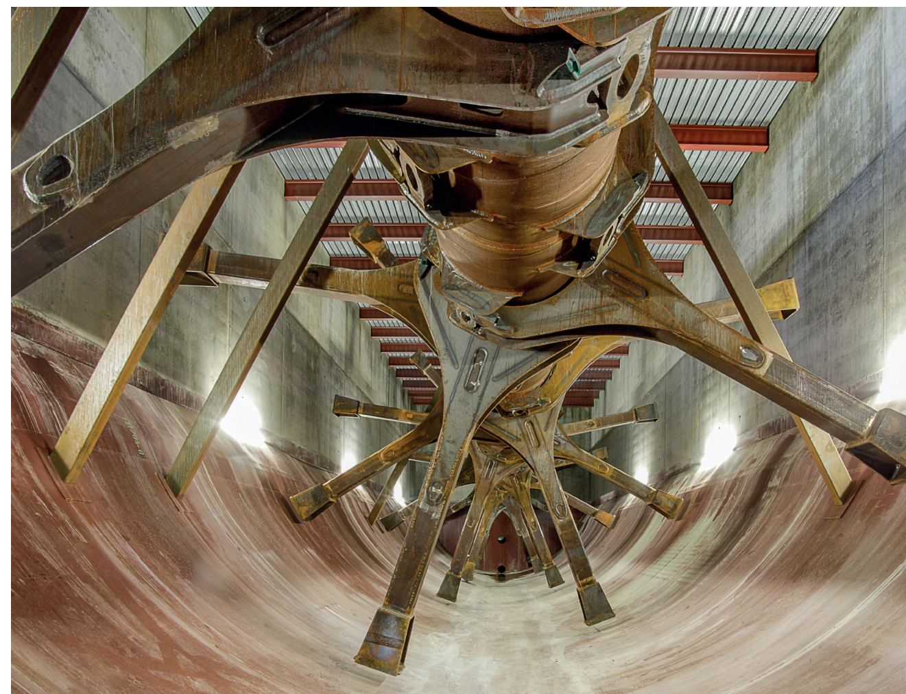
Interno del digestore a secco (TTV).
