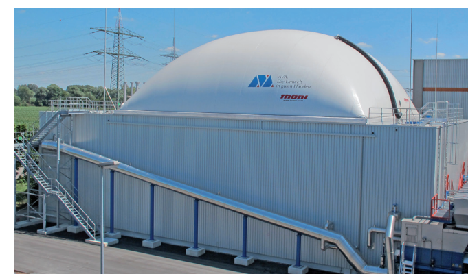
Digestore dotato di gasometro.
