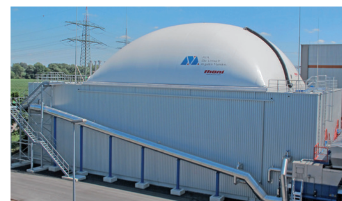
Biogasanlage mit aufgesetztem Gasspeicher.
